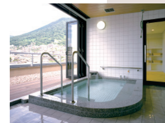
展望浴室(酸素配管があります)
